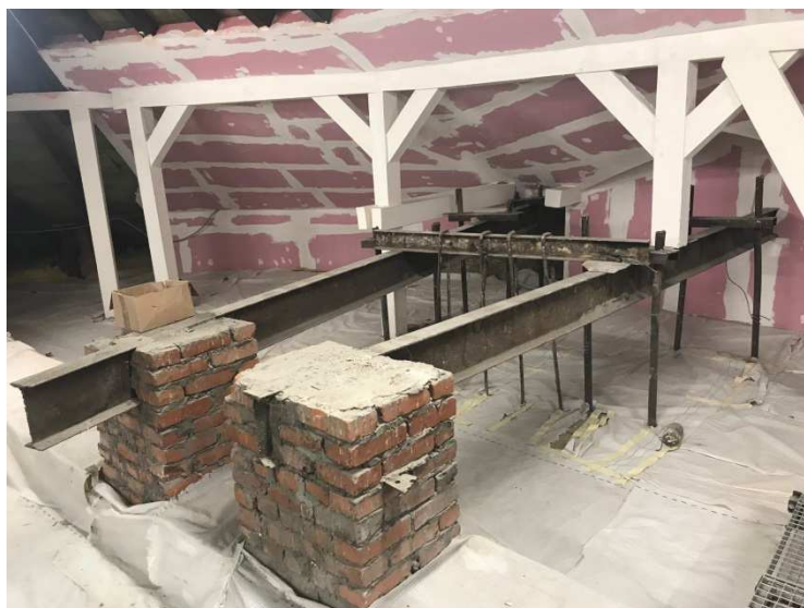
Fot. 23 – Stalowa konstrukcja wsporcza podtrzymująca strop Akermana
