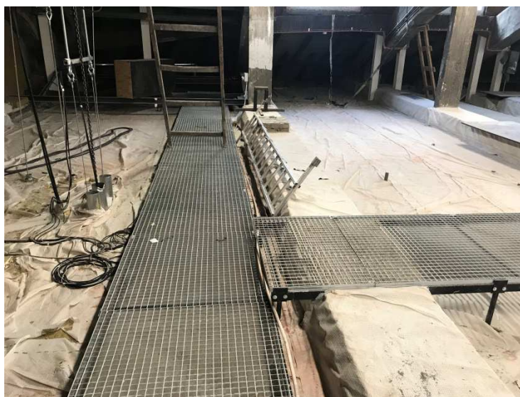
Fot. 32– Pomosty serwisowe na poddaszu oraz tuleje z rur dla lin pod urządzenia niezabezpieczone pod względem p.poż.
