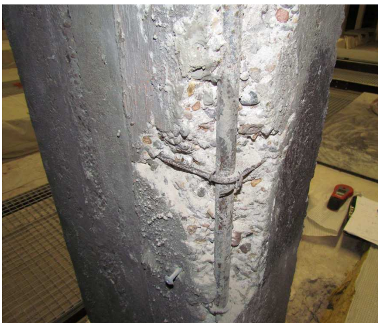
Fot. 27 – Odkrywka zbrojenia w wieszaku dźwigara żelbetowego
