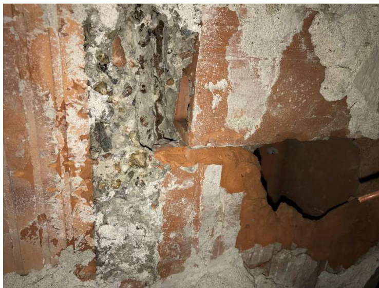
Fot. 13 – Odkrywka zbrojenia w stropie Akermana
