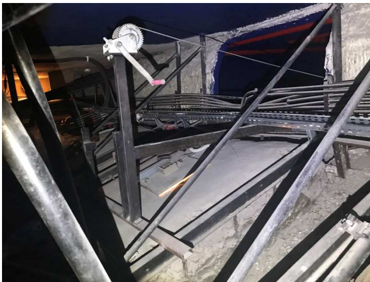
Fot. 5 – Układ prętowy podwieszenia plafonu od strony sceny
