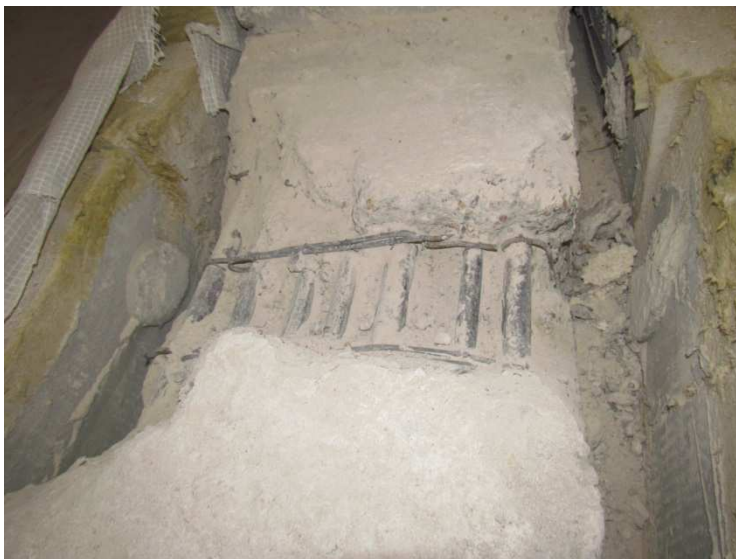
Fot. 25 – Odkrywka zbrojenia pasa dolnego dźwigara od góry
