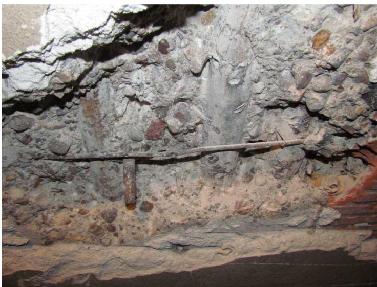
Fot. 15 – Odkrywka zbrojenia pasa dolnego dźwigara od dołu
